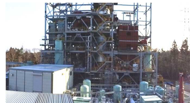
広野町仮設処理施設（平成27年1月）
